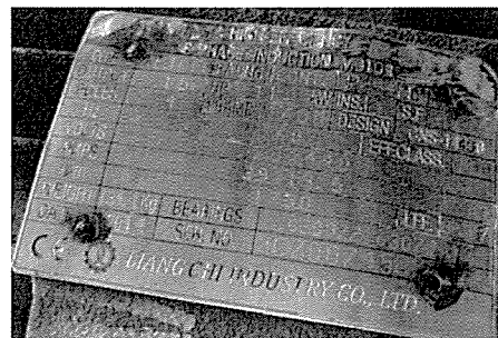
主大樓冷卻水塔馬達15HP 銘牌
