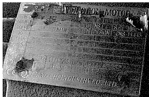
主大樓冷卻水塔馬達15HP 銘牌
